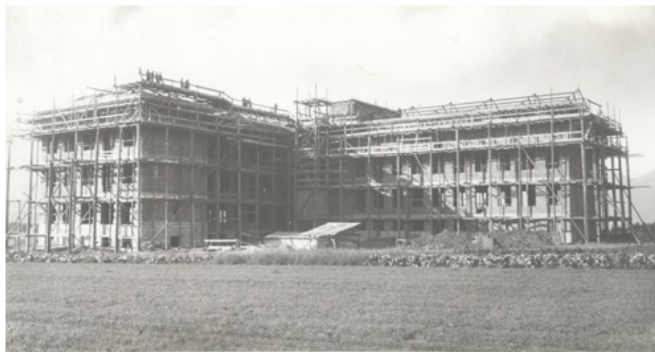
Obr. 5. Stavba druhej budovy SNM v Martine. Celkový pohľad z južnej strany. Fotoarchív SNM v Martine, č. neg. 02 741-001. Foto A. Horník, 1930
